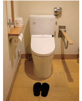
脱衣所に設けられた共用便所 縦手すり及び跳ね上げの手すりが設け られている。
