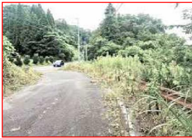
路面の損傷が激しく凹凸が大きい
