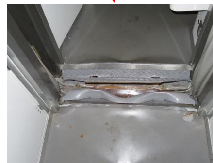
↑3-4号車間渡板変形 (付近の床板も大きく変形)
