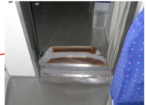
↑3-4号車間渡板変形 (付近の床板も大きく変形)
