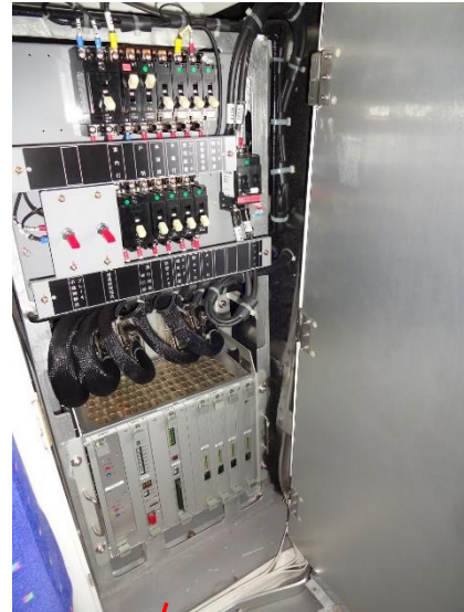
↓2号車機器箱 (妻構体が客室側に変形)
