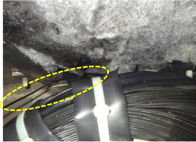
図2 F線がケーブルの束から外れている状況
