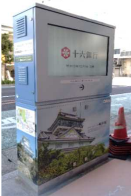
既設の路上変圧器を活用した 観光情報提供
