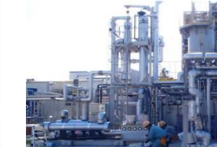
IHI横滨に設置した18Nm 3 /h試験機
