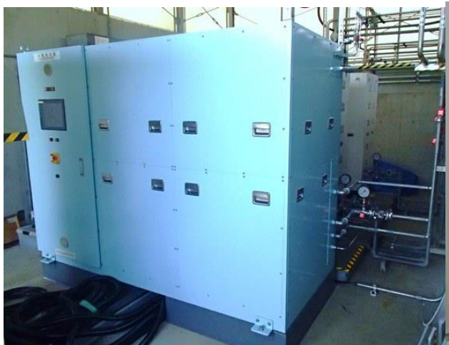
2015 九州大学 伊都キャンパス 水素ステーション (1Nm 3 /h)
