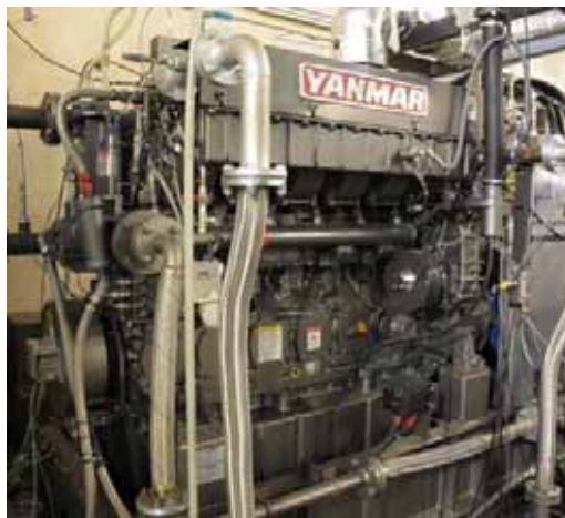
図 4.1.63 400 kW ガスエンジンの外観
