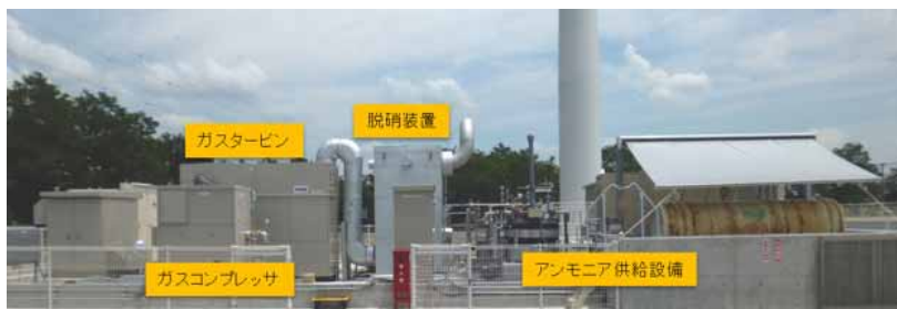
図 4.1.75 アンモニアを直接燃焼できるマイクロガスタービン発電装置 79)
