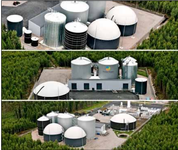
図 4.1.20 Skangas の Lidköping にあるバイオガス・LNG 製造プラント 15)
