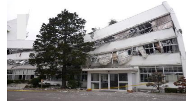
地震により倒壊した大規模建築物
