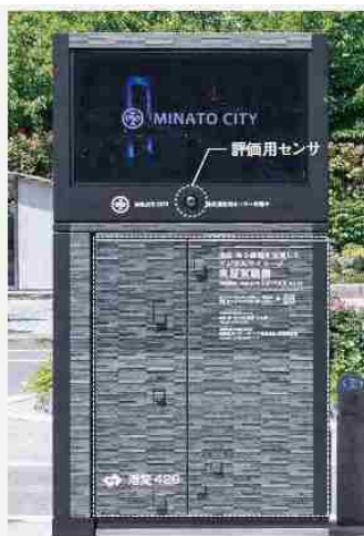
配電地上機器(四角点線)の上に設置されたサイネージ。評価用センサは人流・顔検知システムで録画することなく画面を見ている人を属性も含めてカウントしている
