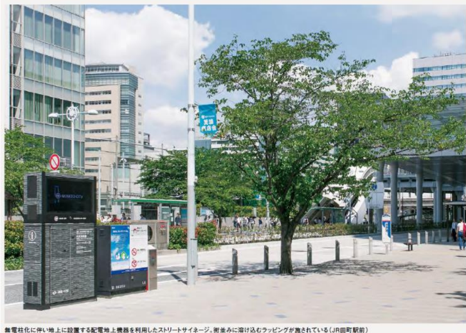
無電柱化に伴い地上に設置する配電地上機器を利用したストリートサインージ。街並みに溶け込むラッピングが施されている (JR田町駅前)
