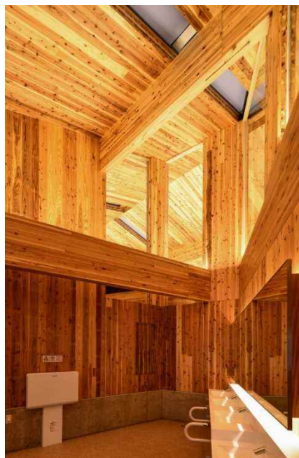
内観見上げ（夜間） 照明は梁上に間接照明として設置
