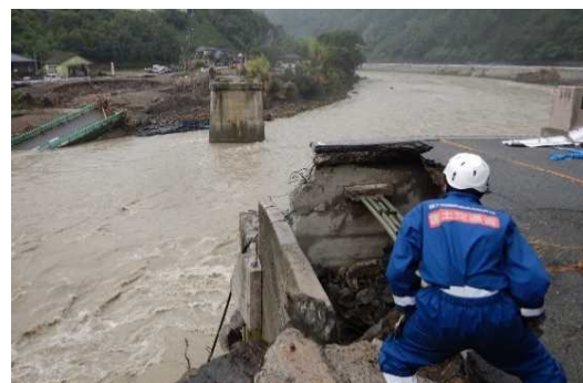
7月9日 被災状況調査 (熊本県球磨村)
