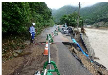
7月12日 被災箇所の現地調査 (熊本県八代市)
