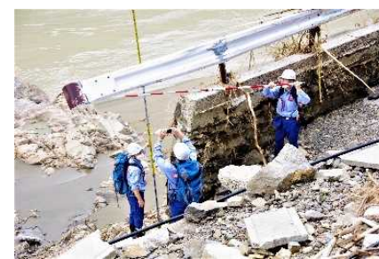
7月8日 被災箇所現地調査 (熊本県球磨村)
