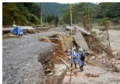
7月12日 被災箇所現地調査 (熊本県球磨村)
