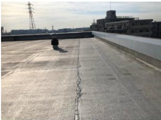
（屋上トップコートの劣化）
