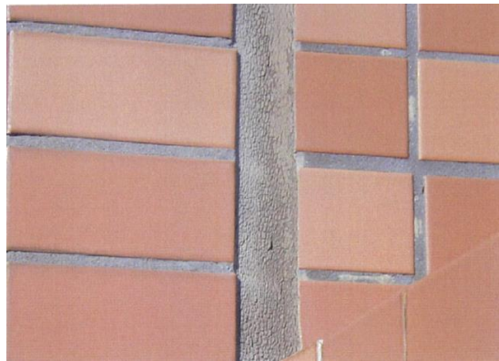
(外壁タイルシーリング硬化・ひび割れ)
