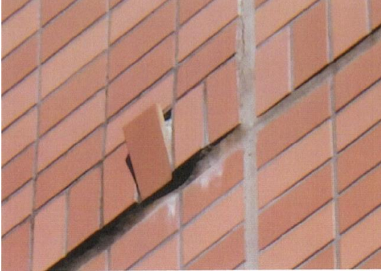
(外壁タイル浮き)
