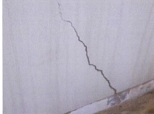
(外壁廊下手摺部ひび割れ)
