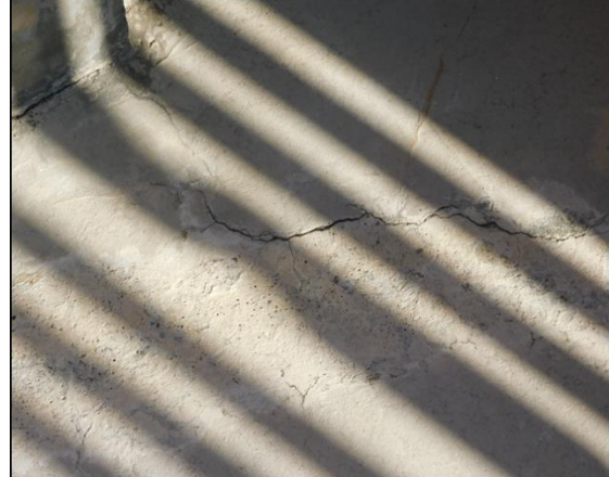
(バルコニー床のクラック)
