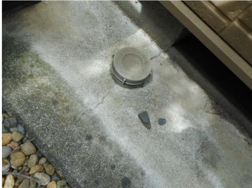
(土間コンクリート汚れ)
