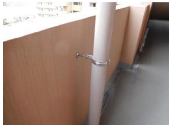
（外壁塗装面の粉塵汚染）
