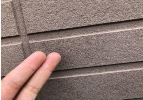
(外壁塗装チヨキング)
