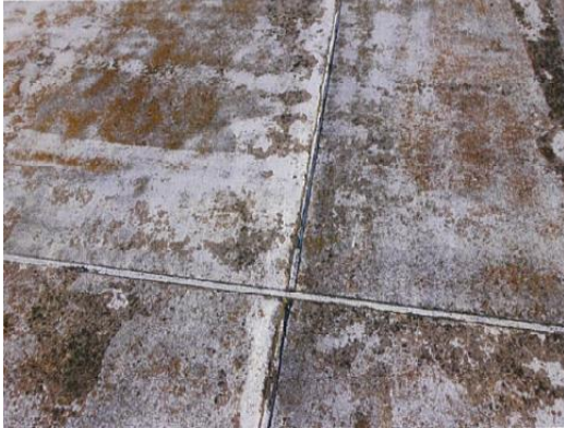
(屋上アスファルト防水劣化)
