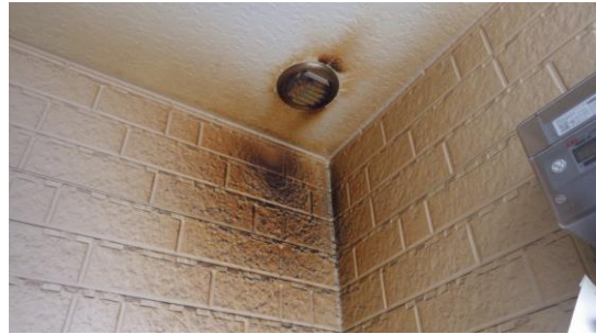
(外壁の一部汚れ)
