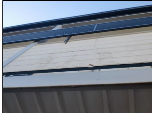
(外壁塗装チョーキング)
