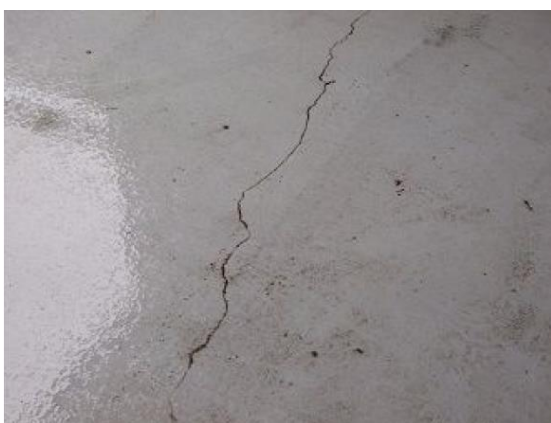
(廊下床ひび割れ)
