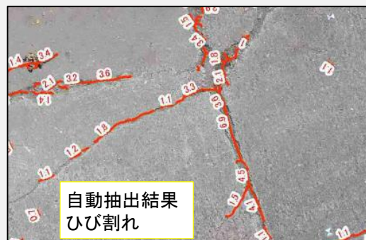
変状抽出の一例
