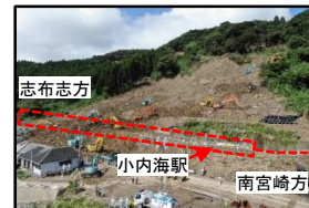
JR九州 小内海駅構内における土砂流入
