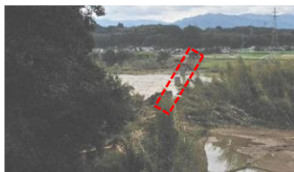
くま川鉄道 球磨川第4橋梁の流出
