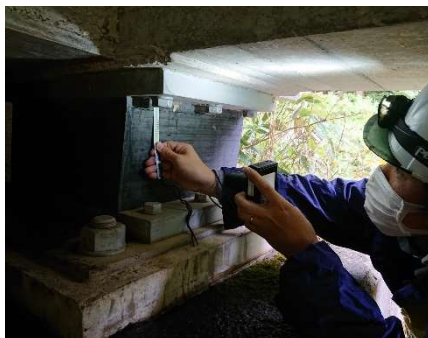
橋梁の被災状況調査(珠洲市)
