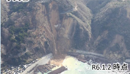
写真③ 国道249号法面崩落
