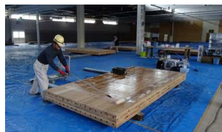
写真-8 CLT 床版防蟻処理の例
