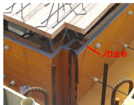
写真-8 コンクリート打設時の汚染防止例 (シーリングのバックアップ材を使用)
