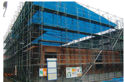
写真-6 屋根状にブルーシートで覆った例
