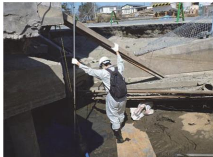
▲ 官庁施設の被災状況調査
