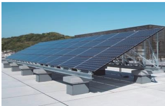
▲ 太陽光発電設備
