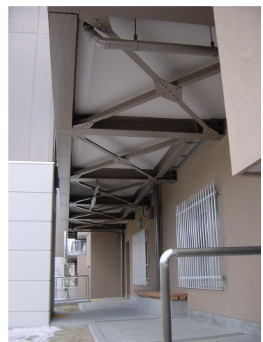
増築された廊下(ブリッジ)を見上げる。増築廊下は鉄骨造。
