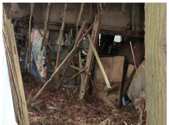
写真2：状態が悪化した空き家
