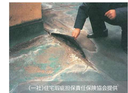
マンション屋上のシート防水接合部が剥がれて躯体が露出し、住戸（専有部分）に雨漏りが発生
