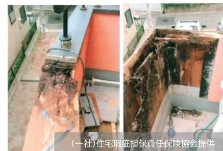
バルコニー手すりの笠木やジョイント部から雨水が浸入し、手すり内部が腐朽
