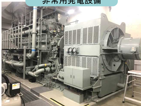
非常用発電設備
