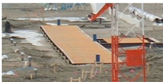
例写真-3.3 液状化後のローライザー基礎周辺の変状
