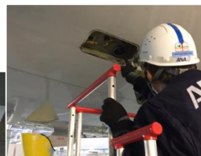
ヒーター付き水排出管
