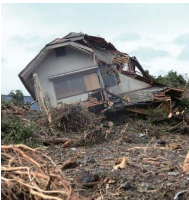
平成25年台風26号の 被害状況(大島町) 提供：東京消防庁
