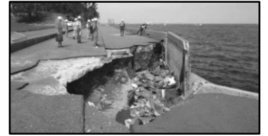
横浜港金沢地区の護岸被災 (令和元年台風第15号)
