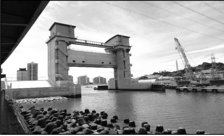
市街地への浸水を防護する水門 (和歌山下津港海岸)
