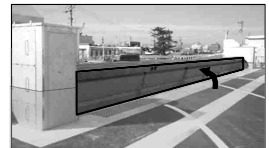
フラップゲート式の陸閘 (津松阪港海岸)
