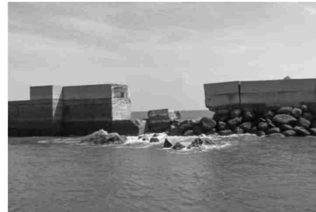
池島港防波堤の被災
