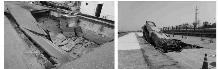
老朽化の進行による港湾施設の破損・事故例
