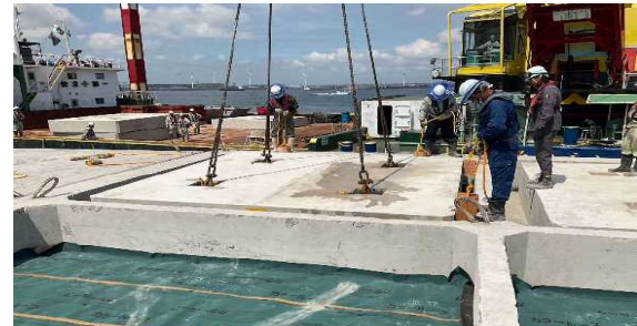
ケーソンの蓋コンクリートのプレキャスト化 防波堤(南)259号
