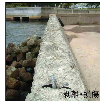
老朽化の進行による 海岸保全施設の損傷例
