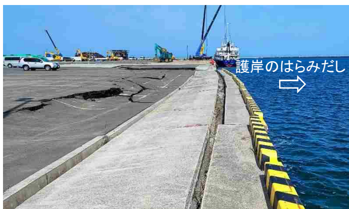
護岸の被災[相馬港(福島県)]
