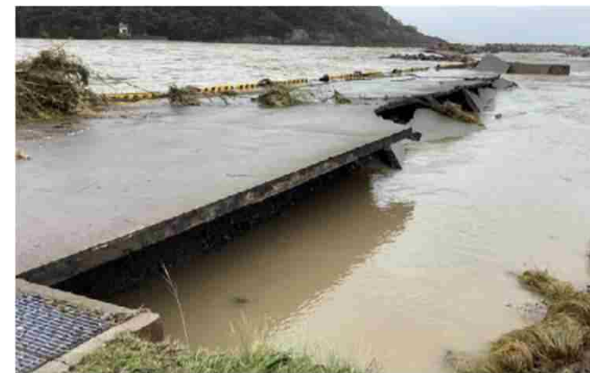
物揚場の被災[美々津港(宮崎県)]
