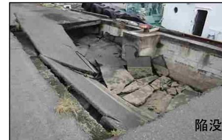
老朽化の進行による 港湾施設の破損例
