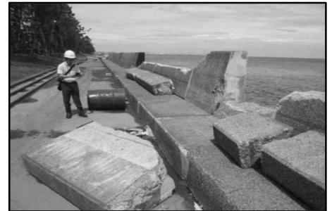
高波による護岸倒壊の事例 [横浜港] (令和元年房総半島台風)
