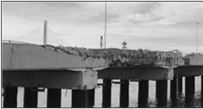
走錨船舶の衝突による橋梁の損傷 (横浜港)
