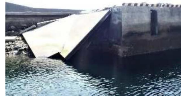
岸壁の被災[安房港(鹿児島県)]
