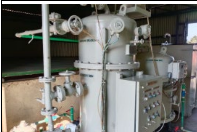
油水分離装置
