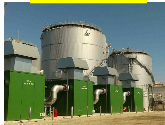
下水汚泥からバイオガスを発生・回収する 鋼製タンク（写真後方）とガス発電機（写真前方）
