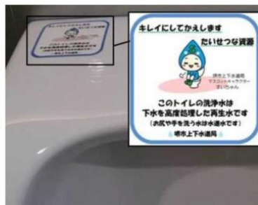
水源利用する大型商業施設内のトイレ
