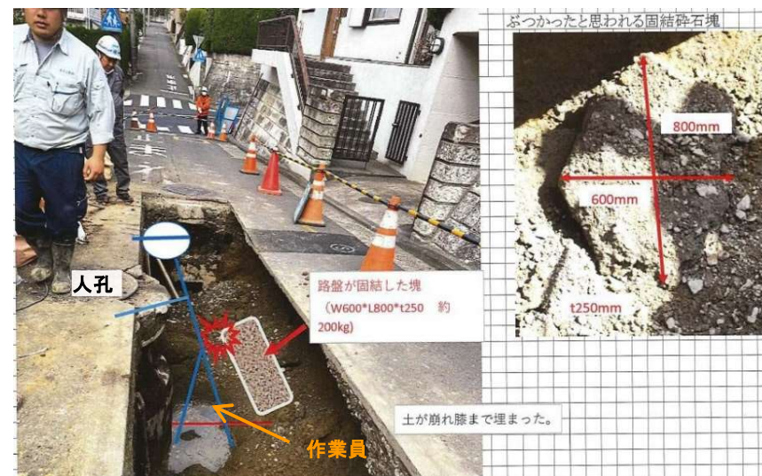
側面の土砂が崩落し、固結した碎石の塊が作業員に当たった
