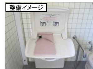
おむつ交換台の設置(2台)
