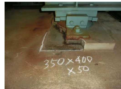
沓座モルタルの欠損
