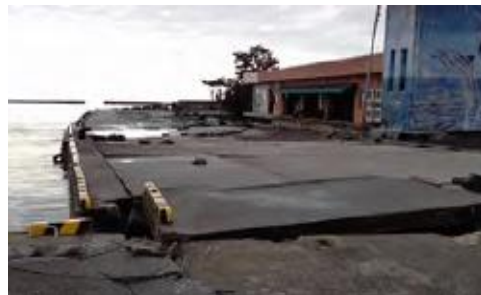
飯田港-5.5m岸壁被災状況
