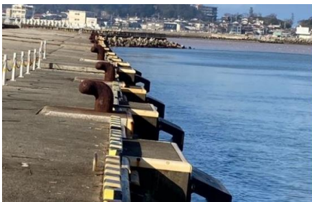
輪島港-7.5m岸壁被災状況
