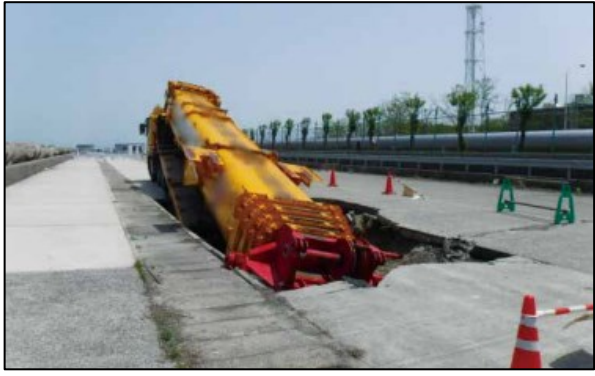
埋立護岸による陥没の発生状況
