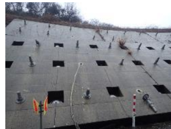
R6被災状況: グラウンドアンカーの破損(飛び出し)
