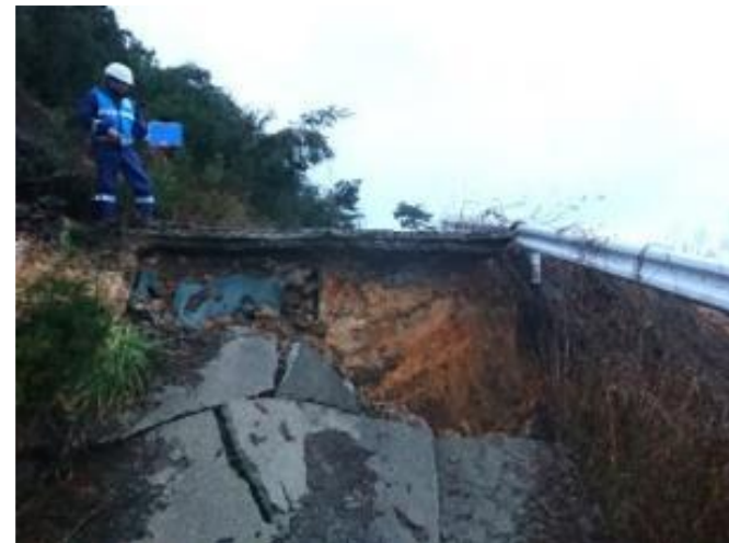
R6被災状況: 地すべりによる段差亀裂
