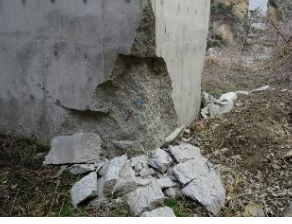
橋脚基部の損傷
