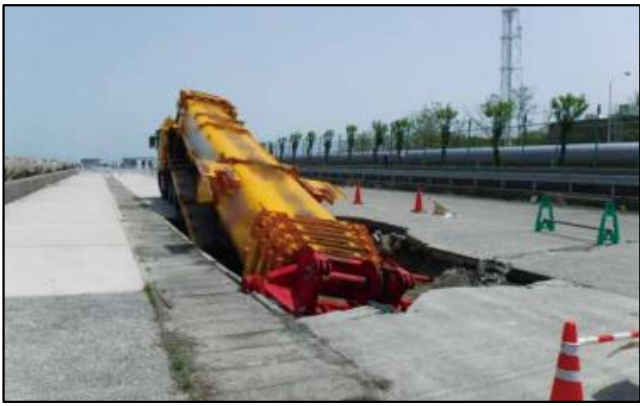
埋立護岸による陥没の発生状況
