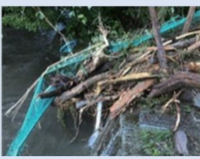
取水門の被災状況
