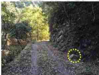
写真-2(法面からの転石)
