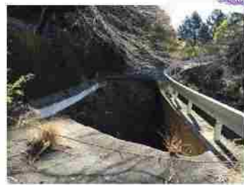
写真-3(道路の一部陥没)
