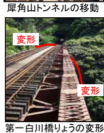
第一白川橋りょうの変形
