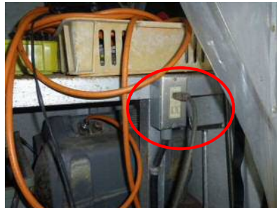
▼ 高島倉庫内の電源(100V×2口)
