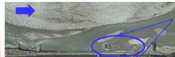
水制工の ブロック流出
