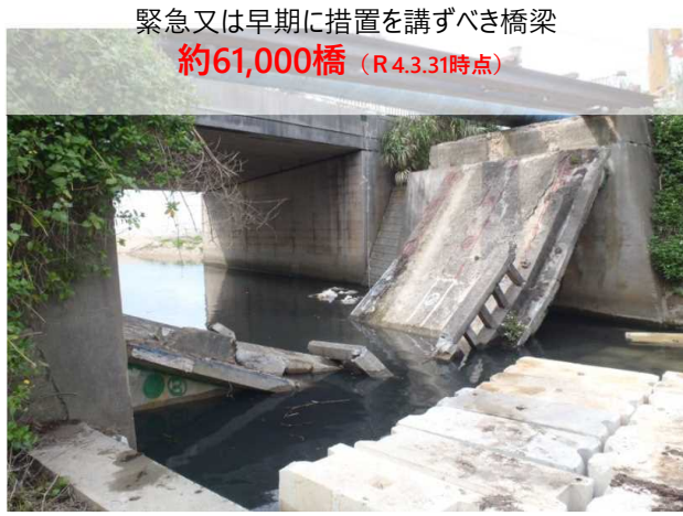
老朽化が原因で落橋した国内事例
