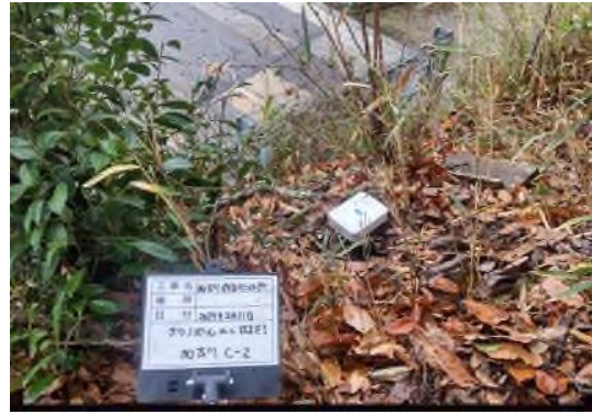
地盤傾斜計 (C-2) 設置状況
