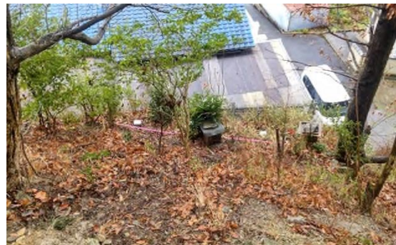
地盤傾斜計全体設置状況
