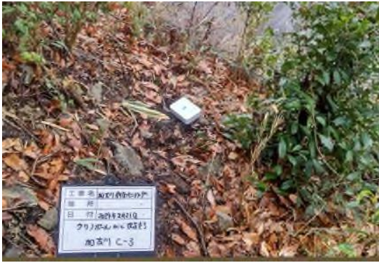
地盤傾斜計 (C-3) 設置状況
