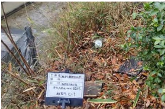
地盤傾斜計 (C-1) 設置状況
